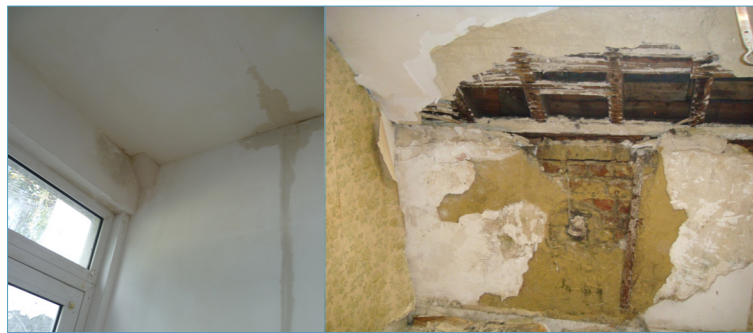
Une infiltration au niveau d'un toit plat après quelques jours.
